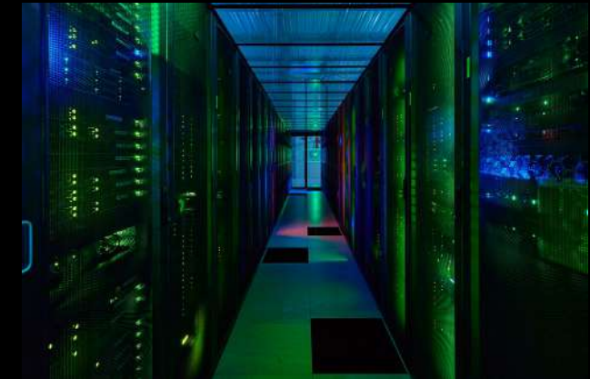
Intérieur du datacenter de Civrieux (01)
