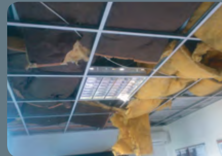
Dégât des eaux
