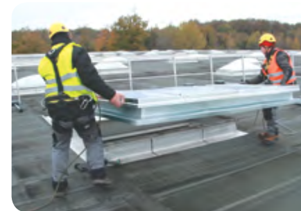
Mise aux normes d'un lanterneau
