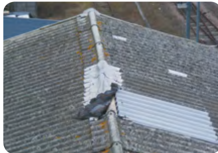
Élément déplacé sur toit amianté
