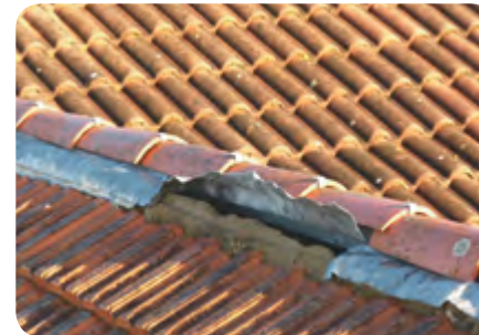
Élément de faîtage cassé
