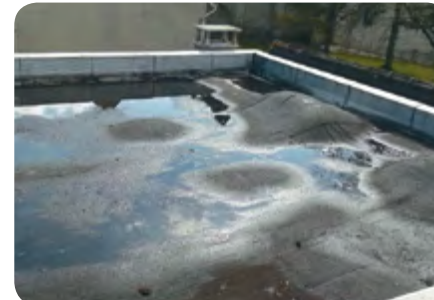
Étanchéité bitume cloquée
