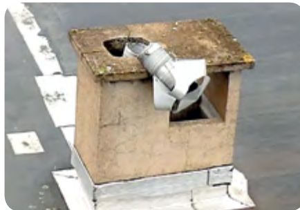
Risque de chute d'élément de toit
